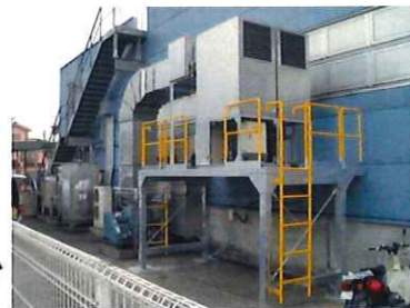
弁当工場 処理風量 10,000m 3 /h
